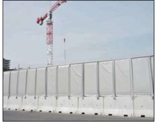
pannello installato su jersey
